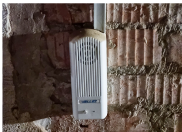
Система оповіщення в укритті
