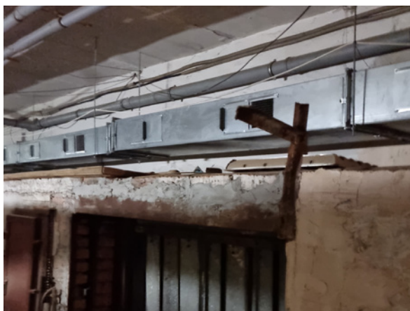
Додаткова примусова вентиляція
